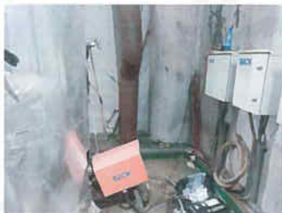
2#排气管 DA002 (Q2) 有组织排放废气
